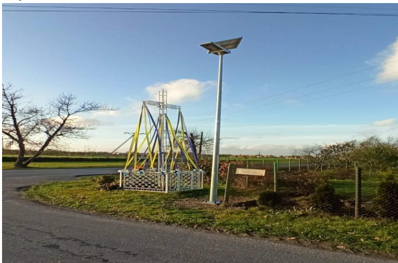
Lampa fotowoltaiczna w miejscowości Brzozów A.
