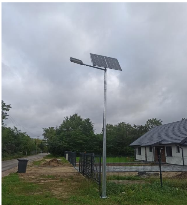
Lampa fotowoltaiczna w miejscowości Uderz
